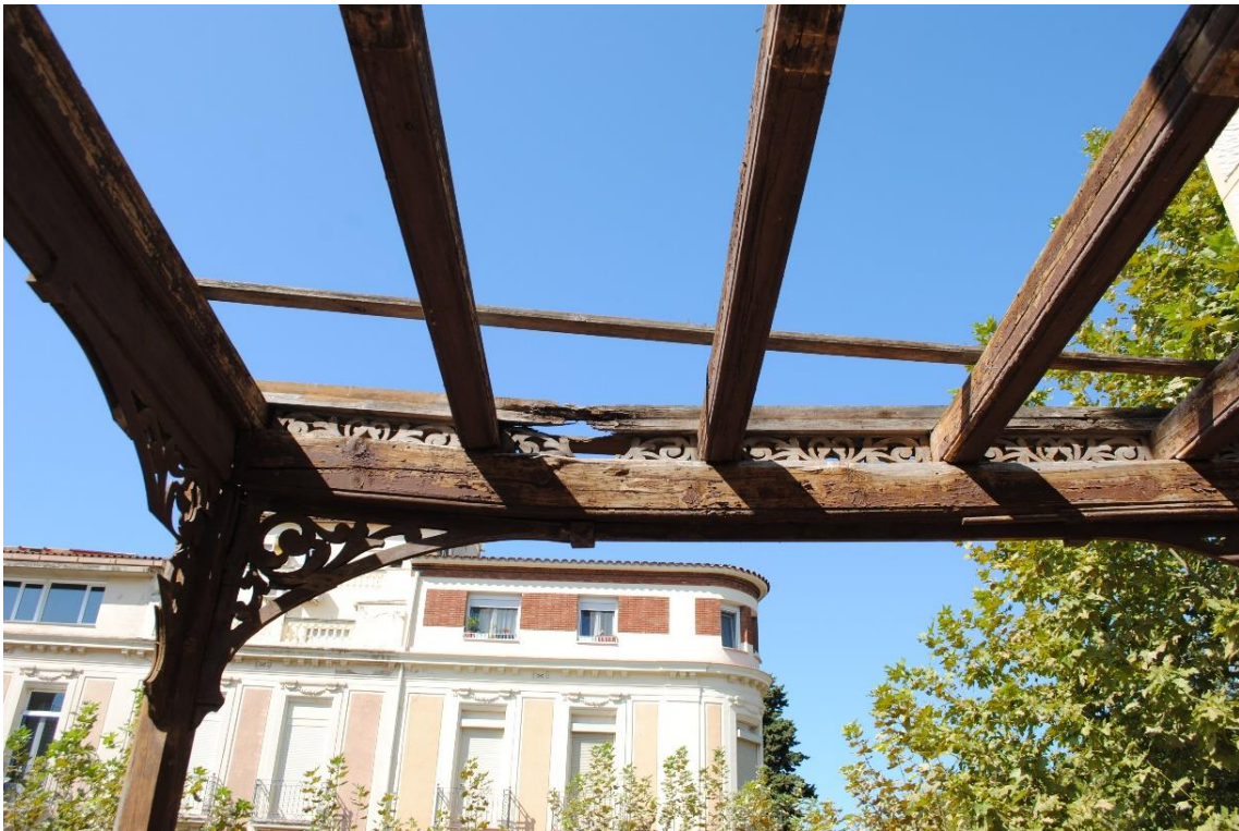
Afeccions a les estructures de fusta. Podriment per humitat.
