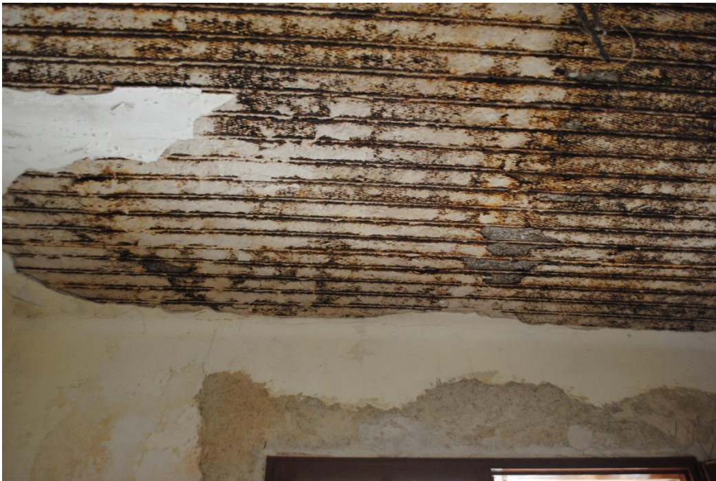
Forjat de llosa de formigó armat de sostre de planta baixa. Estat de corrosió de la malla metàl·lica inferior
